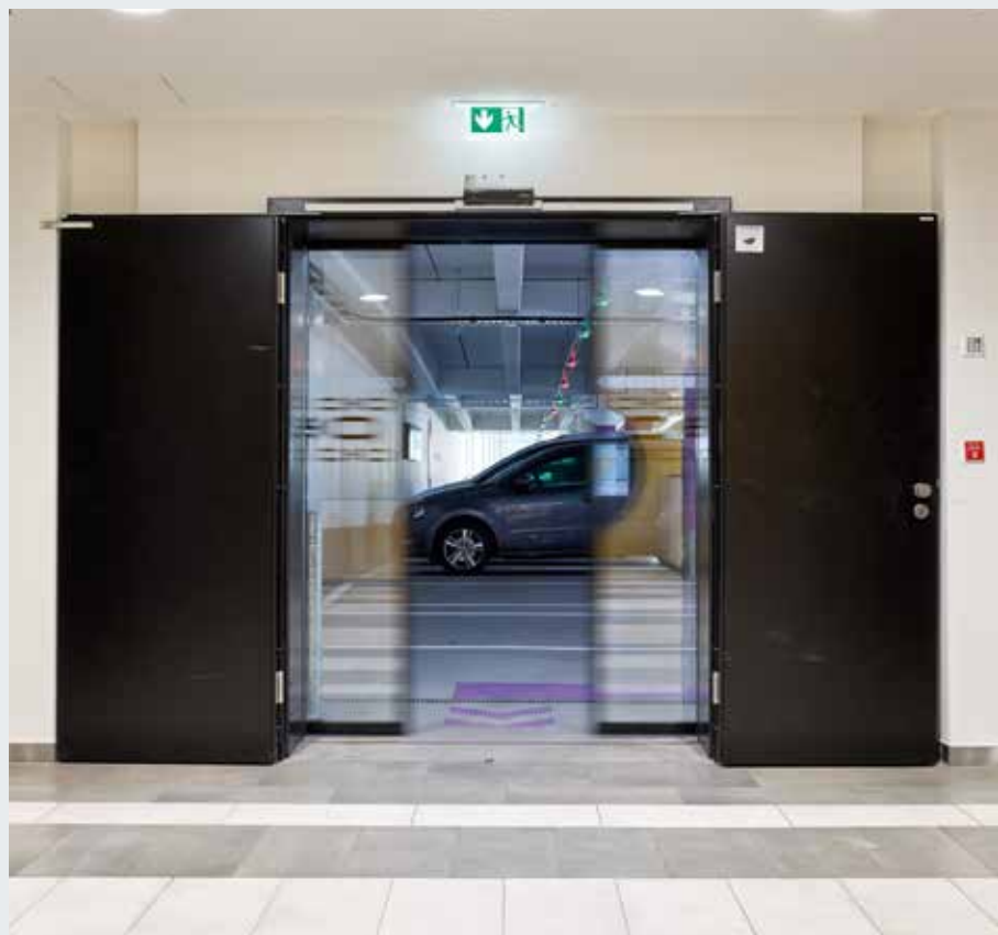
Внешний вид огнестойкой и дымопроницаемой двери (эксплуатация в дневное время)
